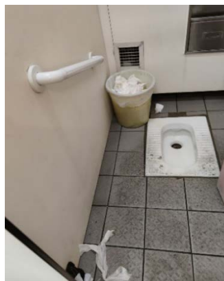
圖 11：廁格地面有垃圾、 垃圾桶裝滿
